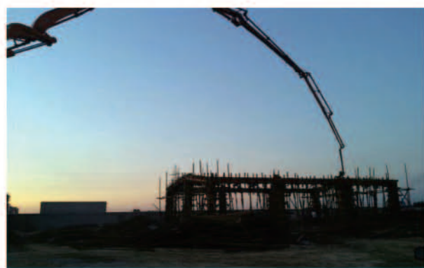
扶余东路加气站
