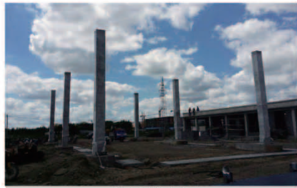
扶余东路加气站
